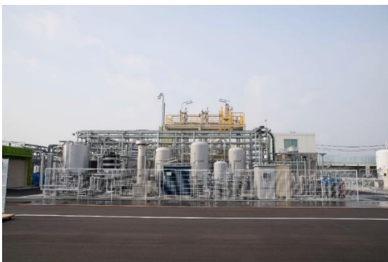
図9 メタネーション実証設備写真
